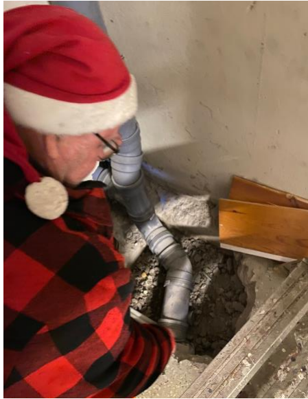
Roine Lauén har bilat upp vid avloppet i pannrummet. Foto: CPJ
