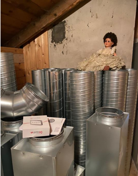
På vinden väntar ventilationen på att installeras. Övervakas av det gamla teatersällskapets docka. Foto: CPJ
