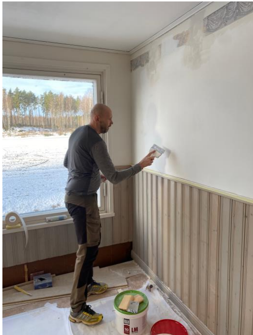
Anders Alé spacklar, slipar och grundmålar i hallen där de gamla toaletterna hade sina dörrar. 2024-02-03Foto: CPJ
